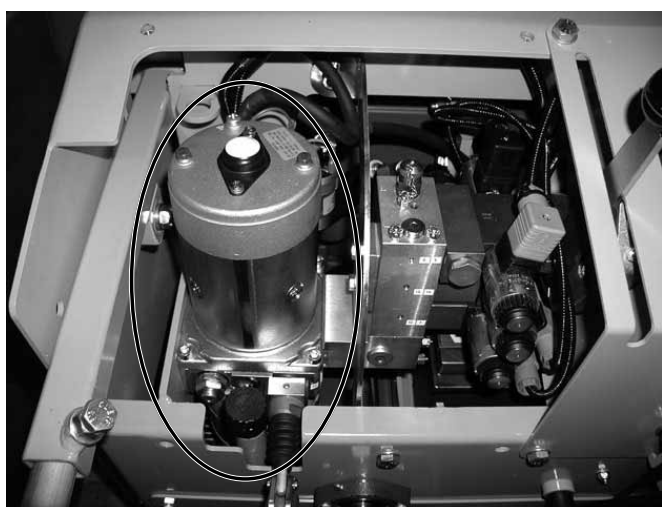
Пульт управления слева, крышка снята, эл-гидравл. компактная маслостанция слева
