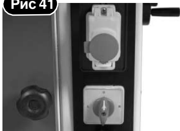
Панель управления станком
